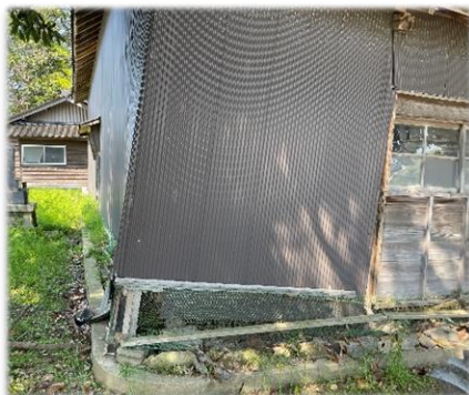
↑基礎の損壊による本堂全体の傾き
