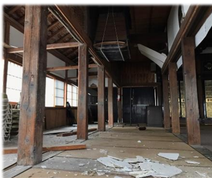
↑壁の剥落や亀裂、梁の落下など
